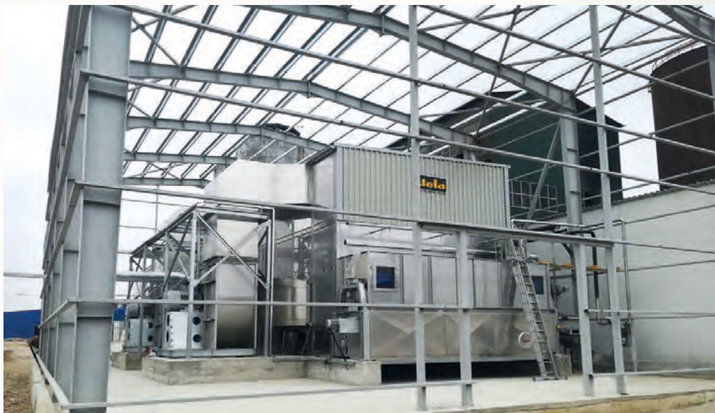
项目地：Vrancart S.A., 罗马尼亚 | 型号：BTU 1/6200-15 | 安装年份：2018 干燥物料：造纸污泥 | 蒸发量：2.35吨/小时
