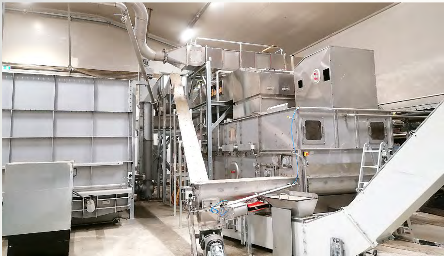
项目地：Ämmässuo 垃圾站，芬兰 | 型号：BTLU 1/2000-6 | 安装年份：2020 干燥物料：市政污泥 | 蒸发量：360 公斤/小时
